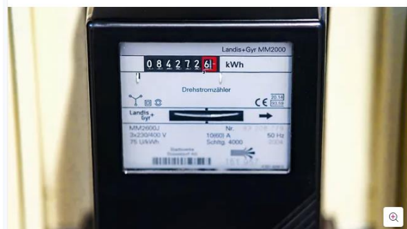
Stromzähler: Die Netze werden derzeit in einem hohen Tempo ausgebaut. (Quelle: IMAGO / Michael Gstettenbauer)
