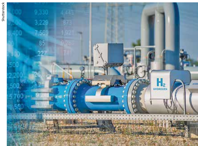
Wasserstoff kann zur Dekarbonisierung des Wärmesektors beitragen.
